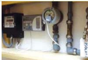
내부에 설치된 계량기
